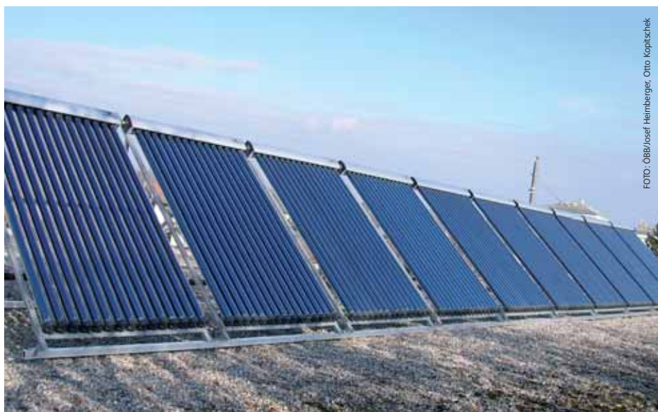
Vakuumkollektoren auf dem Flachdach des ISC-Gebäudes in Tulln
